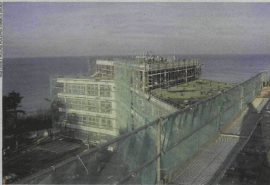
Apartamentowiec Dune w Mielnie na 110 mieszkań. Koniec budowy planowany jest na początek przyszłego roku
