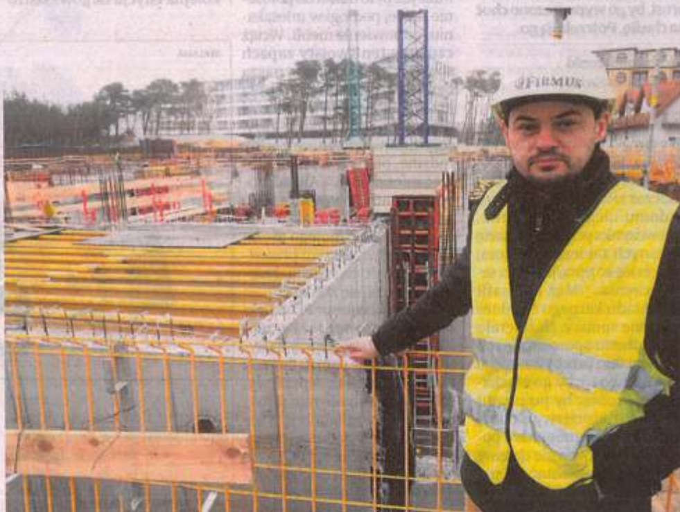
► Cezary Kulesza pokazuje nam postęp prac na budowie apartamentowca Dune B. Na razie gotowy jest poziom garaży, po wakacjach obiekt ma osiągnąć ostatnie, piąte piętro. Budowa Dune C dopiero ruszy
